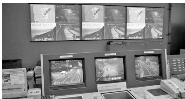
写真2 国道監視管理システム
