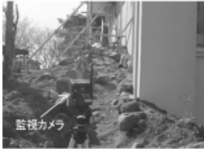
写真-9. 監視カメラの設置
