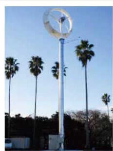
3kWレンズ風車 可倒タワー式 耐風速42m/s 48V独立/バッテリー充電タイプ 水素製造装置 燃料電池1kW 併設
